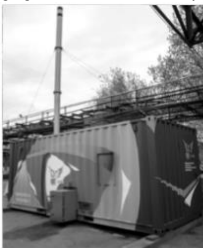
Установка термического обезвреживания отходов «Инвайро»
